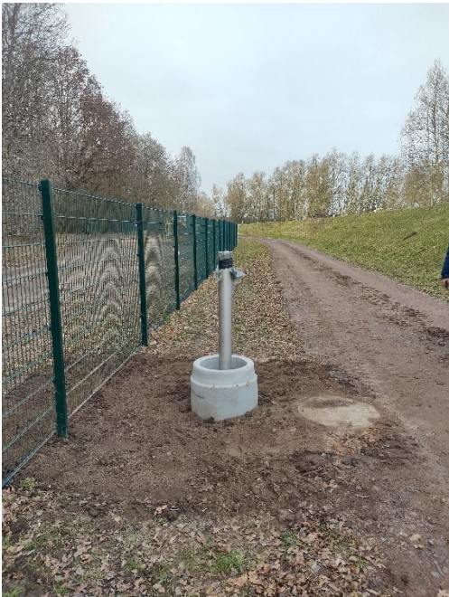
Foto 3: fertig gestellter Entlastungsbrunnen
